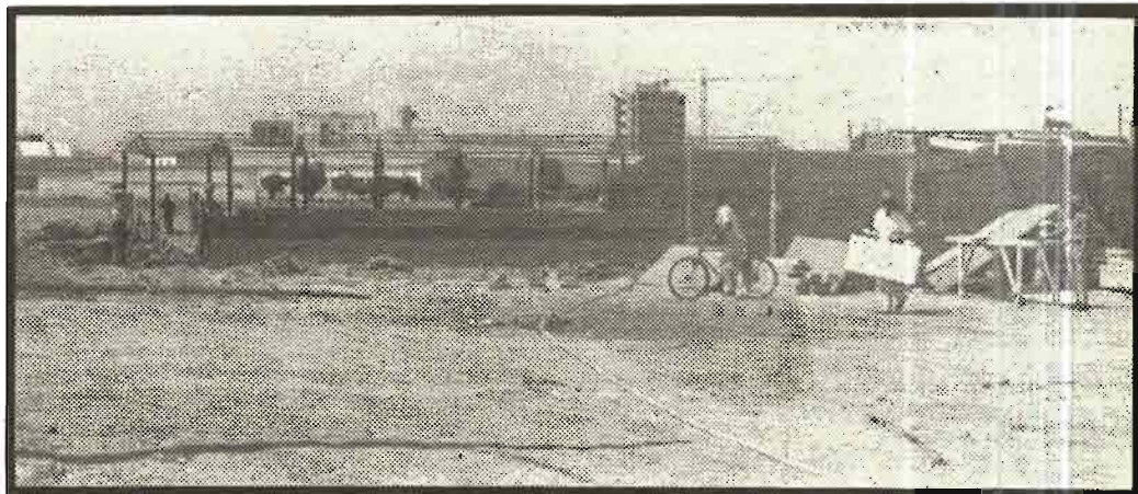
Catorce empresas construyen sus fábricas en la actualidad, en el polígono "Campollano"
