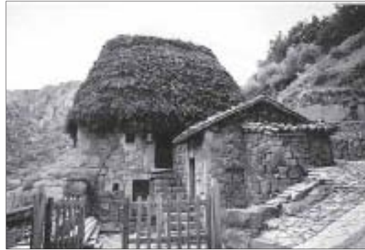
Lámina 9. Construcción-bloque en altura y cubierta de escoba de una braña vaqueira, con la cocina y el horno de pan adosados y cubiertos de teja
