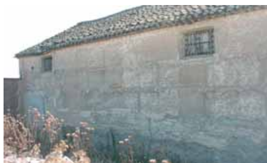
Ejemplo similar en nave cercana, sin brecas)
