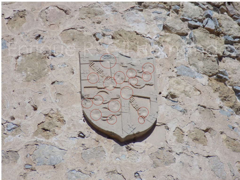
Figura 5. En el escudo nobiliar ubicado en la torre T10 se puede observar una alta concentración de impactos efectuados por arma de fuego.
