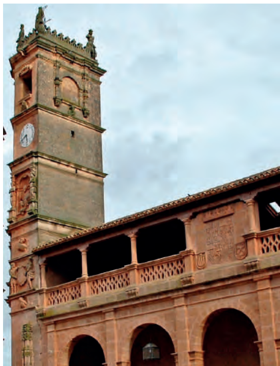
Corredor de la Lonja antepuesto al convento, origen del problema.
