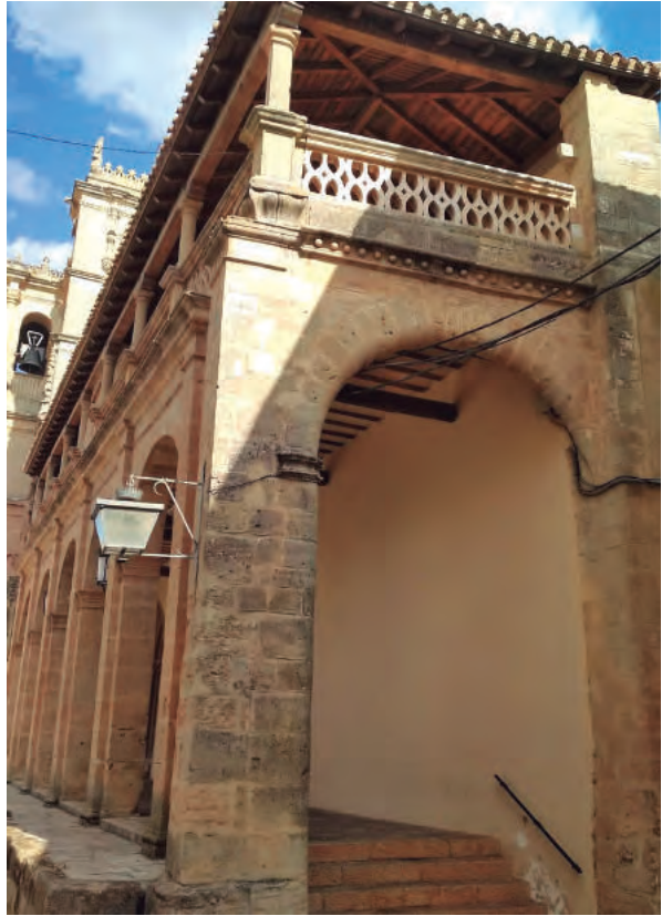
Lateral Oeste de la lonja: arco de medio punto rematado con bolas abulenses y un antepecho gótico
