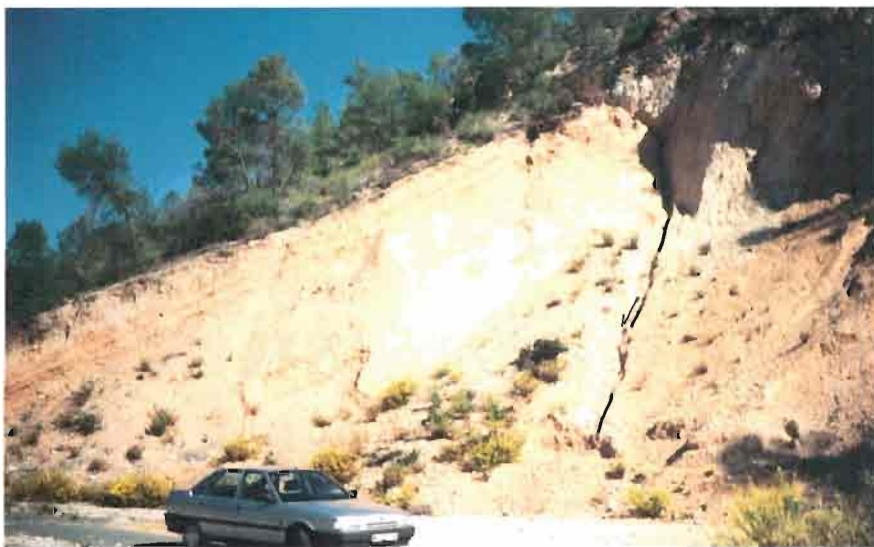
Foto 9. Falla normal que afecta a un piedemonte cuaternario, al Sur del Embalse de la Fuensanta.
