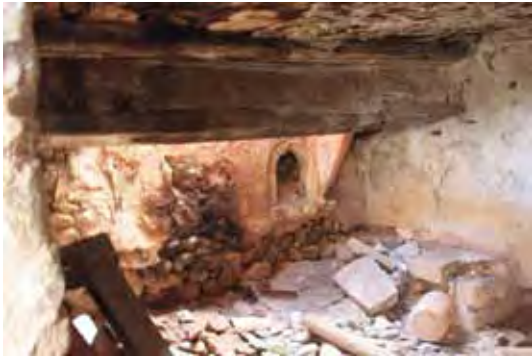
Fig. 104.- Chimenea y horno de la casa de los pastores de El Santo (Alcaraz)
