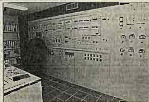
Panel de control de la estación depuradora. / FOTO MANUEL FODIO
