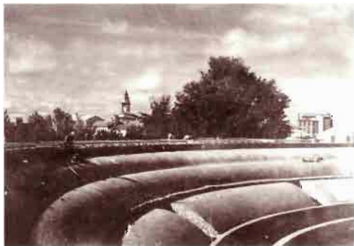
La Plaza de toros en plena construcción. Puede verse las bóvedas que conformarán los asientos de los graderíos y los vomitorios
