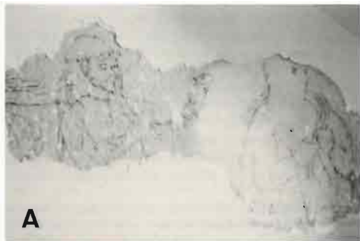
Foto A.- Pintura descubierta en el muro posterior de la ermita
