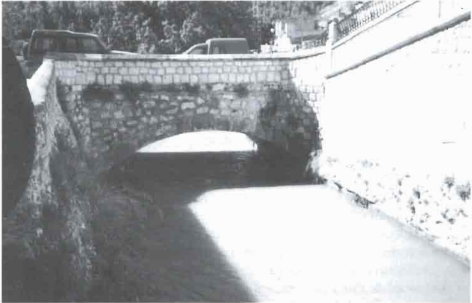
3.5 Arranque del canal que lleva agua a la central eléctrica unos metros río abajo. El canal se superpone a una estructura más antigua para la conducción de agua hacia un molino río abajo.
