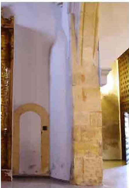
Restos de la puerta de la escalera de caracol, para subir al coro, en la Capilla de los Nieto. Foto: Álvaro Fernández Gil
