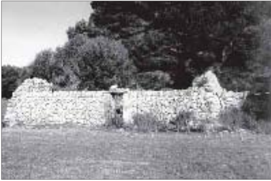
“Barraca de roter” con la cubierta derruida.
