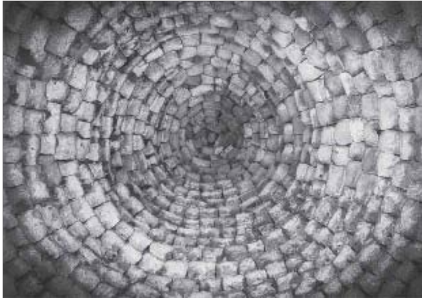
9. Detalle de la técnica constructiva utilizada en las barraques de bestiar más elaboradas. La cubierta, en forma de peonza invertida, está construida por aproximación de hiladas de piedras perfectamente trabajadas y ensambladas entre sí.
