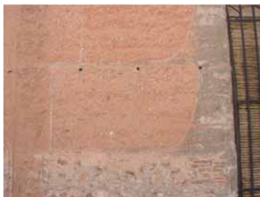
Tapia con juntas reforzadas y brecas en las jambas (Villarrobledo)
