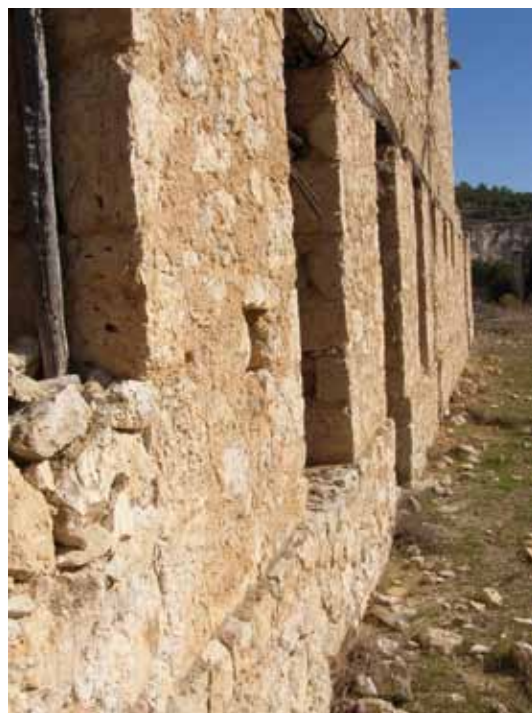
Cerramiento de mampuestos sobre zócalo del mismo material. Casa de la Central Eléctrica. La Recueja
