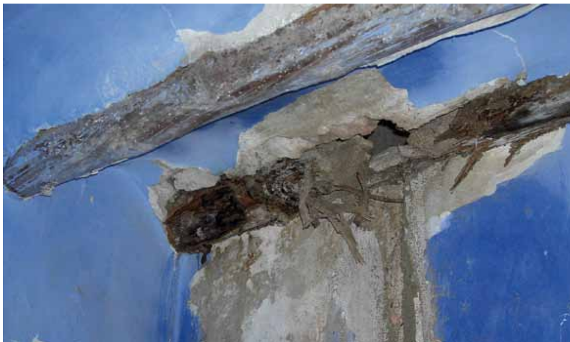
Viguetas gravemente afectadas. La humedad favorece el ataque de xilófagos.
