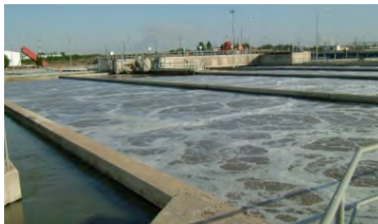
Figura 2: Vista general de una depuradora con fangos activos.
