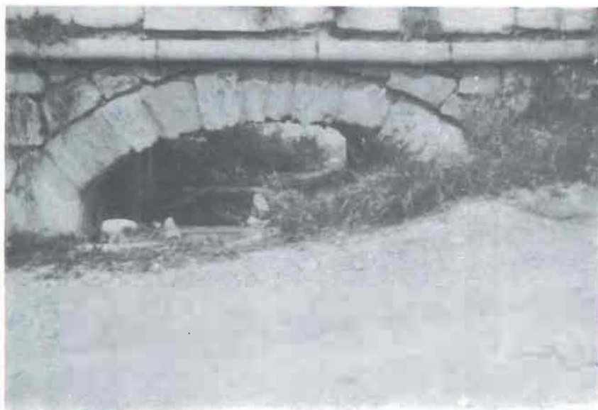
Puente número 3.- Vista del arco aguas abajo antes de ser obstruído por un amontona- miento de basuras y escombros.
